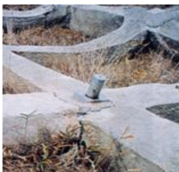
写真 受圧構造物の破損の例
