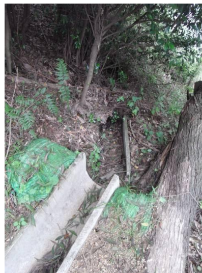
写真 排水溝の破損の例
