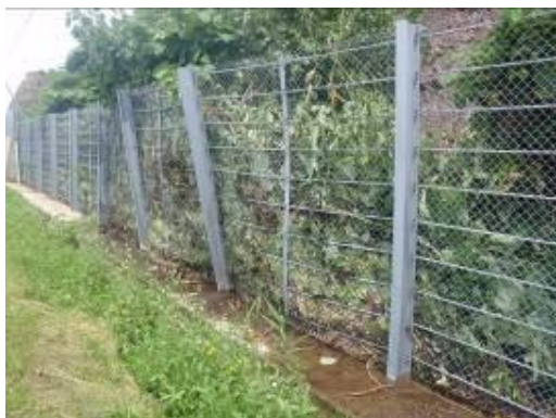
写真 落石防護柵の傾動の例
