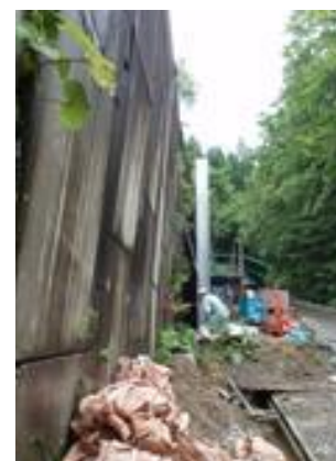
写真 壁面の傾斜の例
