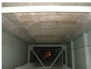
ひび割れの発生
