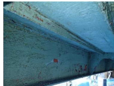
桁の塗装劣化やさびの発生
