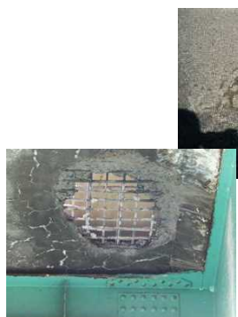
(床版下面) 床版の抜け落ち
