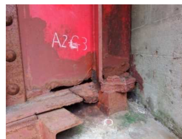
桁端部の腐食・貫通
