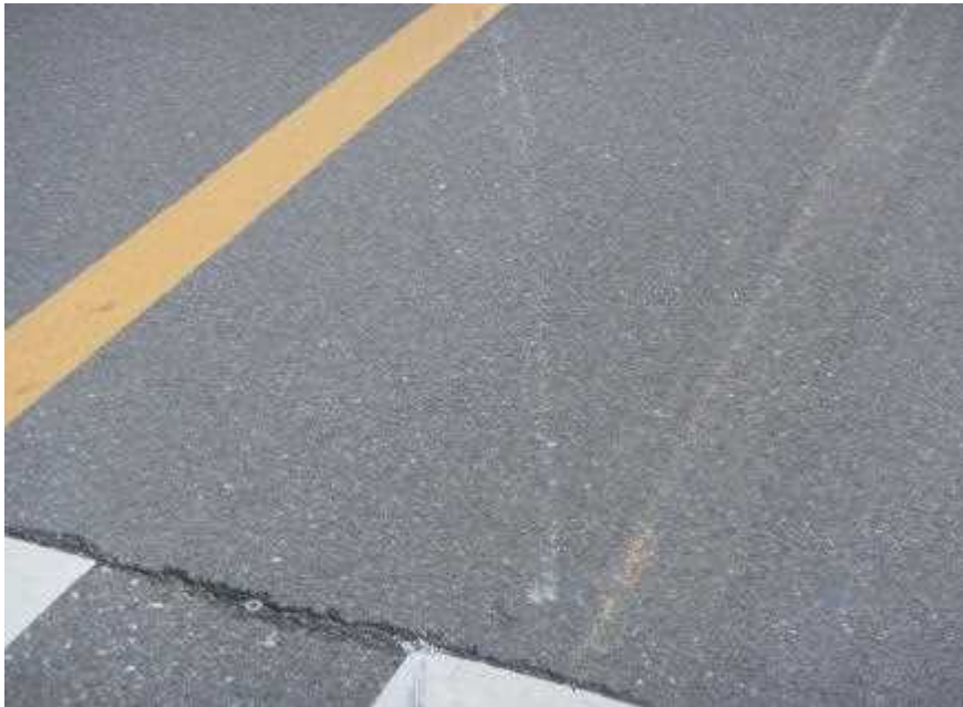
写真7 当該車両に引きずられた信号柱の跡
