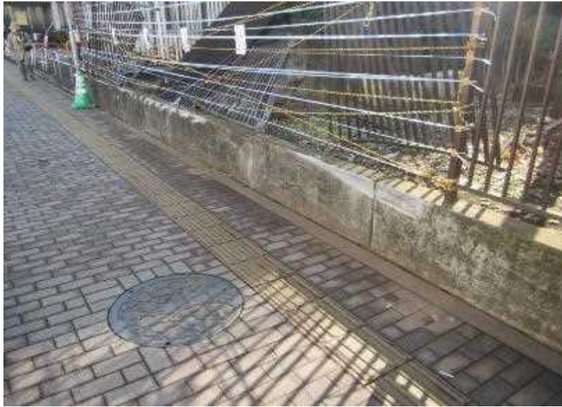
写真3 当該車両が衝突したコンクリート製土留
