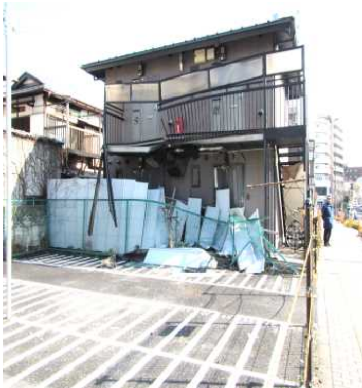
写真 10 当該車両が衝突したアパート
