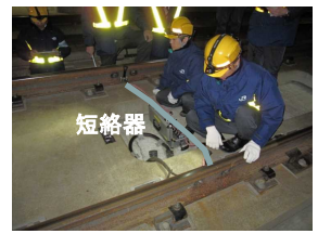
軌道短絡のイメージ ※写真のイメージは建設時のもの。今回のシステム改修に際しては、信号通信機器室内で軌道短絡の模擬を行い試験
