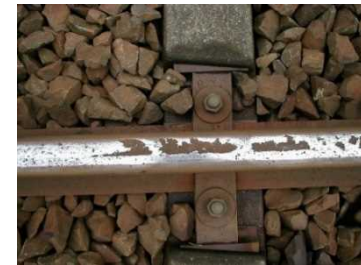
剥離損傷のイメージ※
