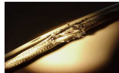
損傷した配線
