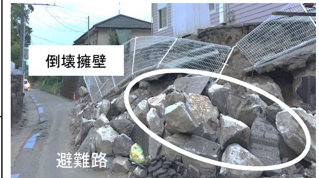
小規模擁壁の被害
