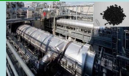
固形燃料化炉 (広島市西部水資源再生センター)
