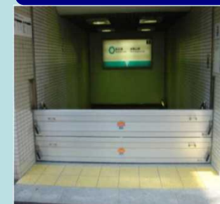
【地下鉄駅の止水版による浸水対策、BCP等】
