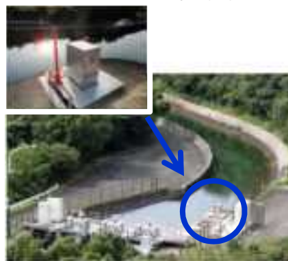
二川調節堰と発電設備(H27.5運転開始)
