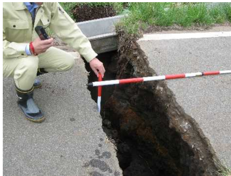
亀裂によって農道に生じた開口
