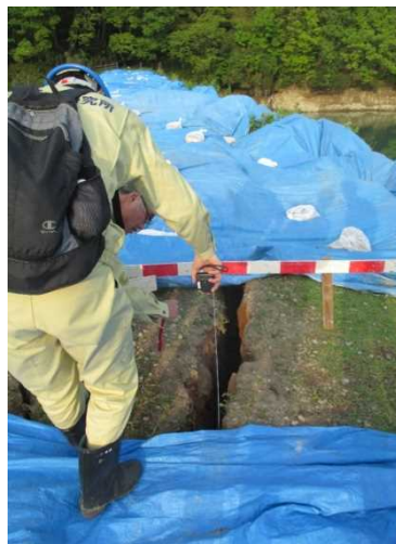
亀裂状況調査
