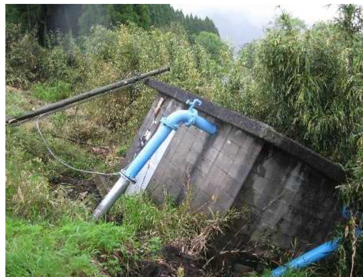
亀裂の発生で転倒したポンプ場
