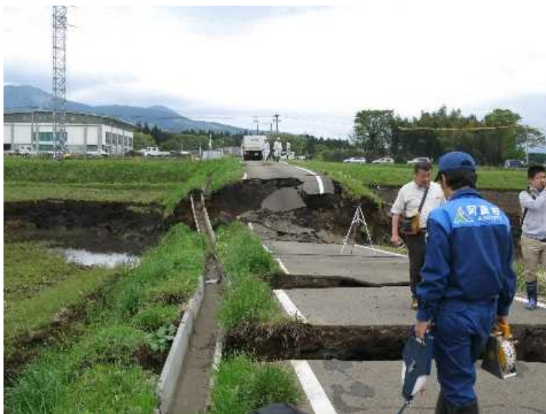
亀裂によって大きく損壊した農道と用水路
