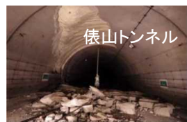
俵山トンネル 覆工コンクリートの崩壊
