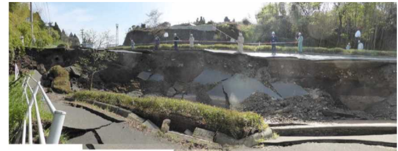
路面陥没地付近の状況（4月15日）
