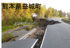
熊本県益城町 盛土の崩壊
