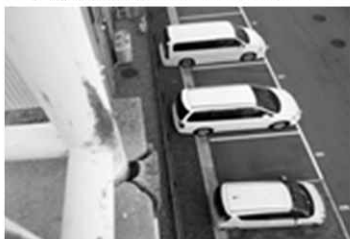
手摺り支柱部モルタルの浮き
