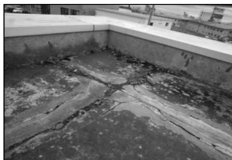
防水押さえコンクリートの損傷
