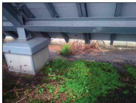
屋上で繁茂した雑草
