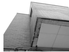
外壁タイル落下
