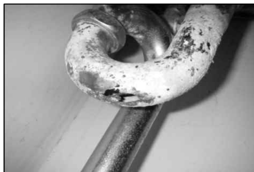
排水トラップの劣化
