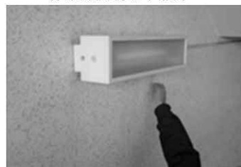
非常用照明の不点灯
