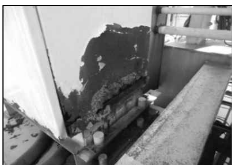
屋外制御盤のさび
