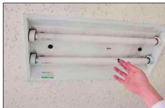
非常用照明器具の電池切れ
