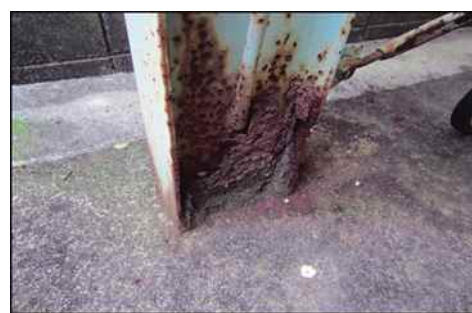
腐食した自転車置場の支柱
