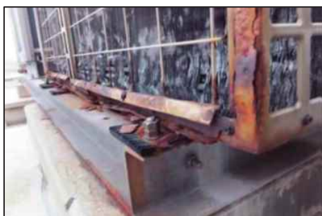
腐食した屋外機
