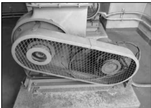
ファンベルトの切断
