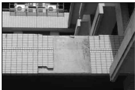
外壁タイルの落下
