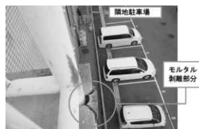
屋外階段手すり部の異常
