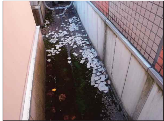
はく落したタイル
