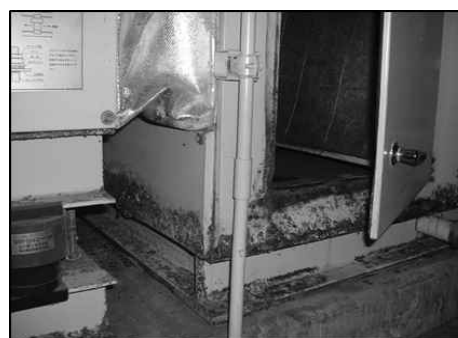
ユニット形空調機の腐食
