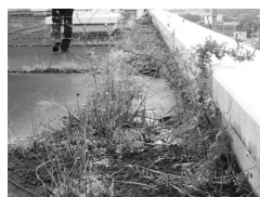
屋上目地部の雑草
