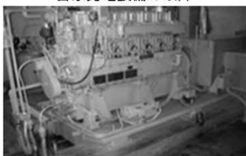
自家発電設備の故障
