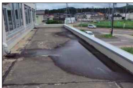
排水口が詰まり雨水が溜まった屋上
