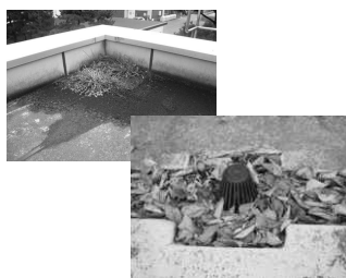
ルーフトレンの清掃不良
