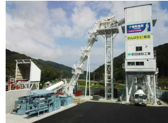
国交省仮設プラント（岩手県釜石市）
