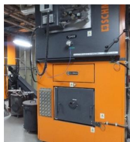
下川町： 木質バイオマスボイラー
