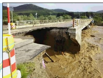
国道38号 太平橋 橋台背面洗掘 (南富良野町)
