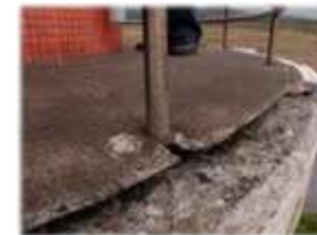
[踊場床モルタルの剥がれ]
