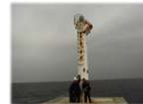
[灯台本体の腐食・汚損状況]
