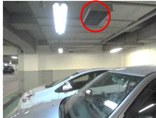
②給気ダクト及び吹出口
