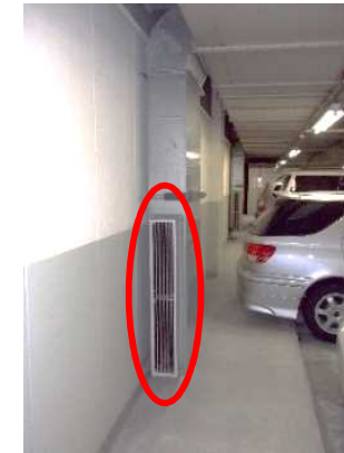
③排気ダクト及び吸込口
