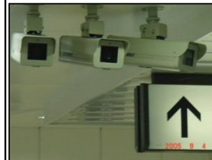
●防犯カメラの設置
