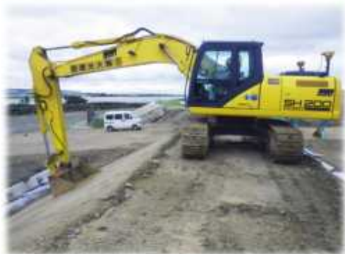
河川堤防の法面整形工におけるMGバックホウでの実効性を確認
