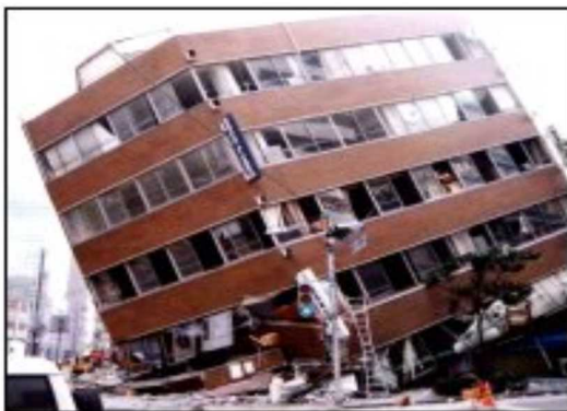
事務所ビル1, 2階の崩壊
