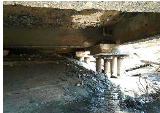
建物基礎が露出
