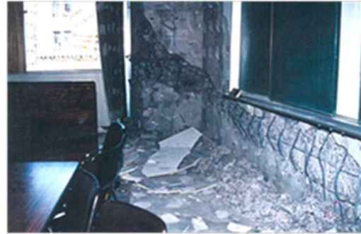
内部の被災状況
