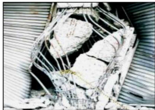
店舗1階柱の圧壊
