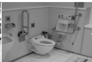
障害者対応型トイレ
