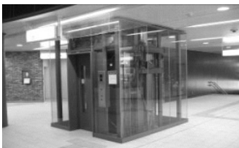
エレベーター
