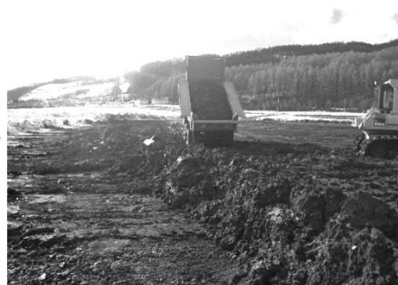
被災農地の復旧状況
