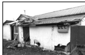
越波による家屋等の被害 (苫小牧市)
