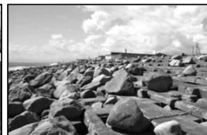
護岸へ基礎石が飛散 (苫小牧市)
