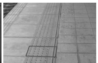
内方線付き点状ブロック
