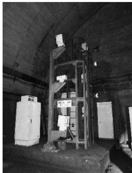
【火災検知装置の例】
