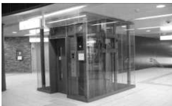
エレベーター
