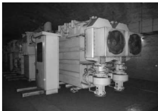
【変電所設備の例】
