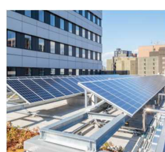
前橋地方合同庁舎 (前橋市・27kW規模)
