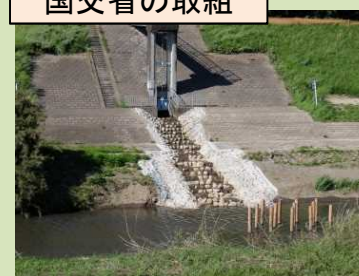
河川と流域水路との連続性を再生する樋管の落差解消
