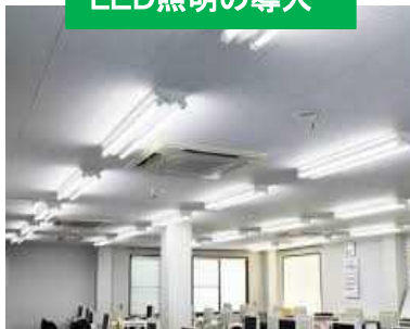
LED照明の導入
