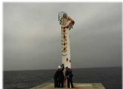
〔灯台本体の腐食・汚損状況〕
