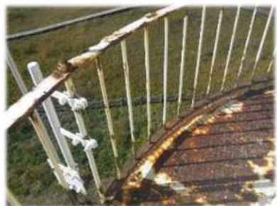
〔踊場の腐食状況〕
