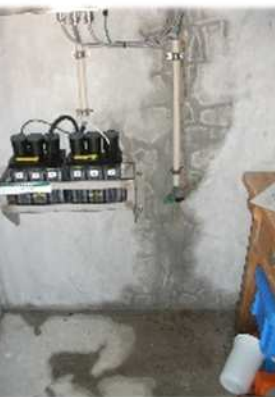
〔室内への漏水状況〕
