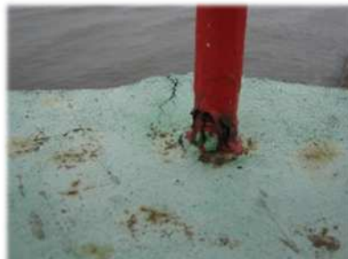
〔踊場手すりの腐食状況〕
