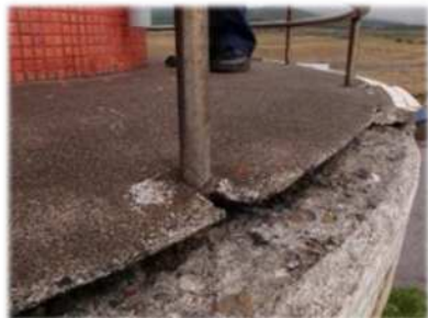
〔踊場床モルタルの剥がれ状況〕
