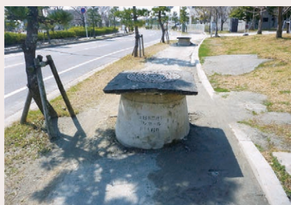
液状化によるマンホールの浮上
