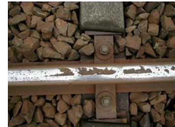
剥離損傷のイメージ※
