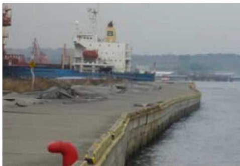
被災事例(はらみ出し)
