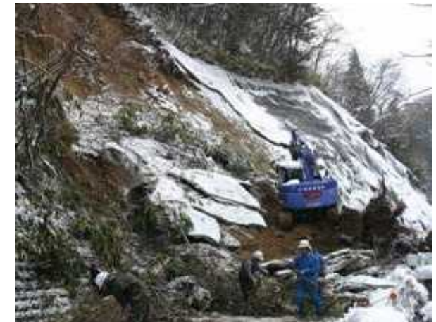
《国道183号の法面崩壊状況》
