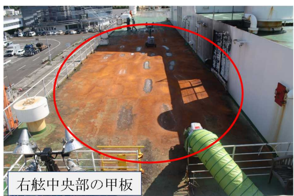
写真3 第4甲板右舷中央部の損傷状況
