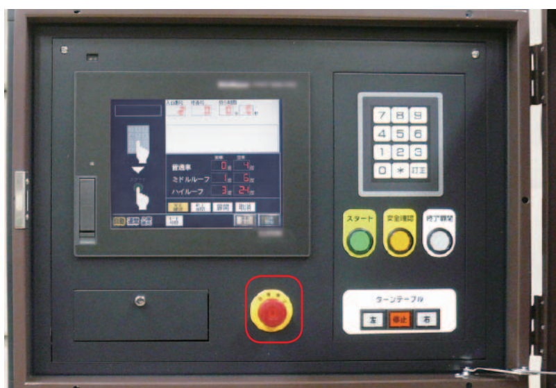
緊急停止ボタンの設置例
