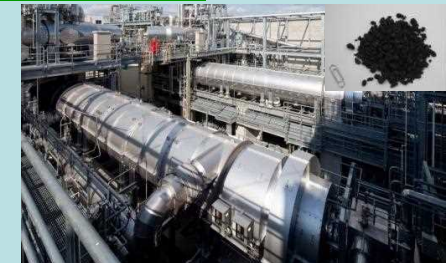
固形燃料化炉 (広島市西部水資源再生センター)
