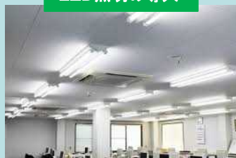
LED照明の導入
