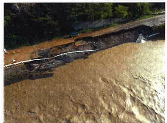
②被災状況
