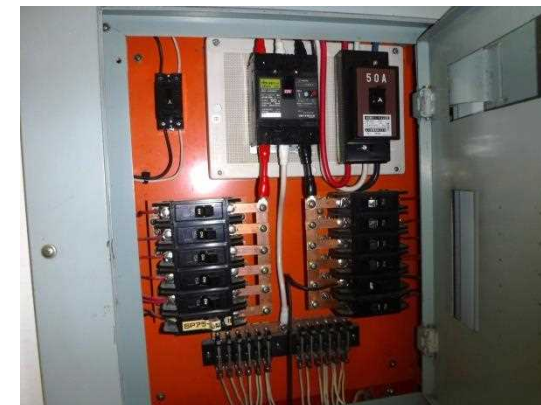
電気設備：動力盤、監視設備等に経年劣化が見られる
