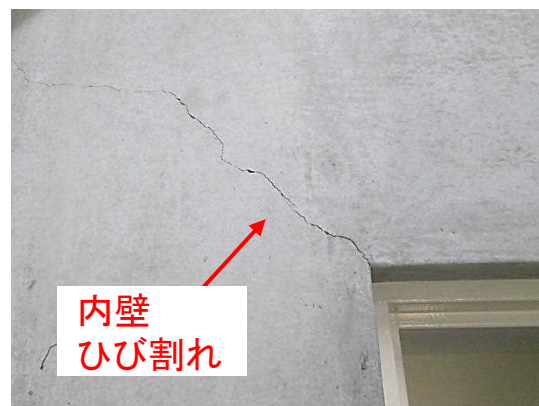
内壁：ひび割れや仕上げ材の劣化が見られる
