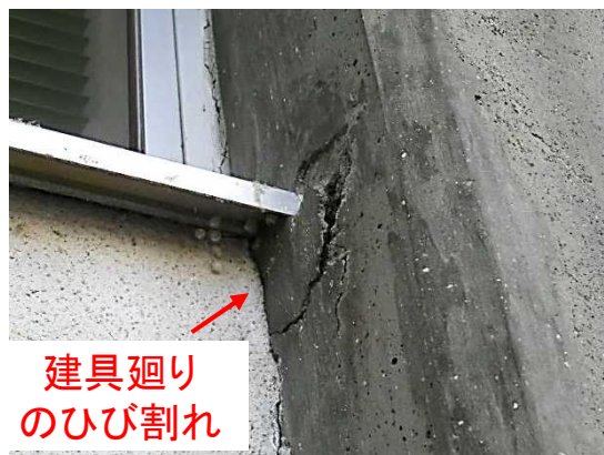
外壁：建具廻りの躯体にひび割れが発生している
