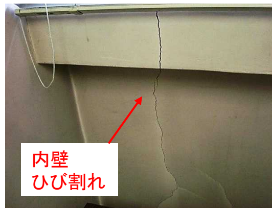
内壁：ひび割れや仕上げ材の劣化が見られる
