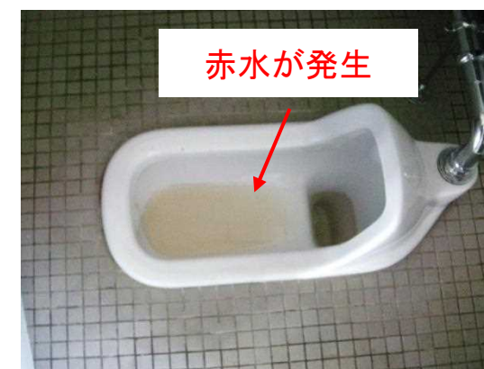
機械設備：給水設備の経年劣化により、赤水が発生している
