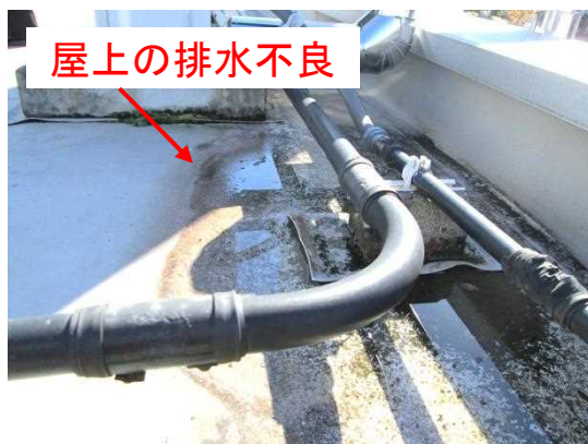
屋上：屋上防水の膨れの劣化により、排水不良が発生している
