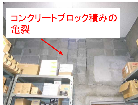
物品庫：コンクリートブロック積み劣化により、亀裂が発生している
