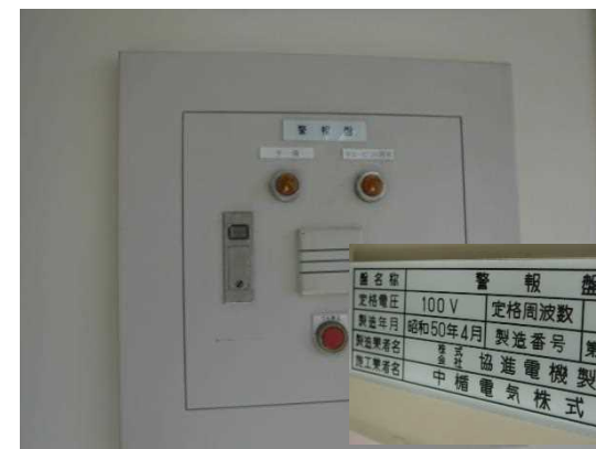
電気設備：警報盤等に経年劣化が見られる
