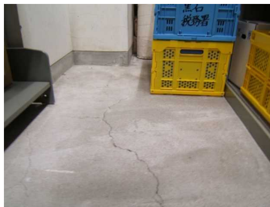
書庫：床にひび割れが発生
