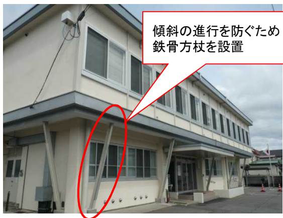
庁舎：2階床はね出し部分が傾斜
