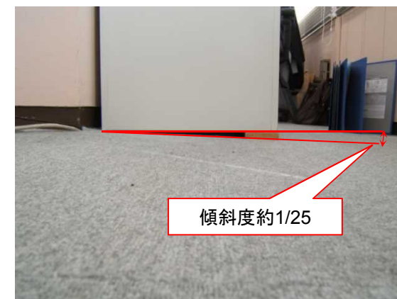
執務室内：床の傾斜状況→床の傾斜度約1/25
