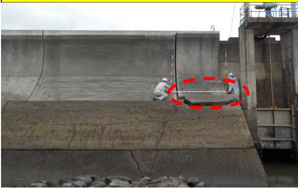
ひゃっかんこうかいがん 百貫港海岸（護岸破損）
