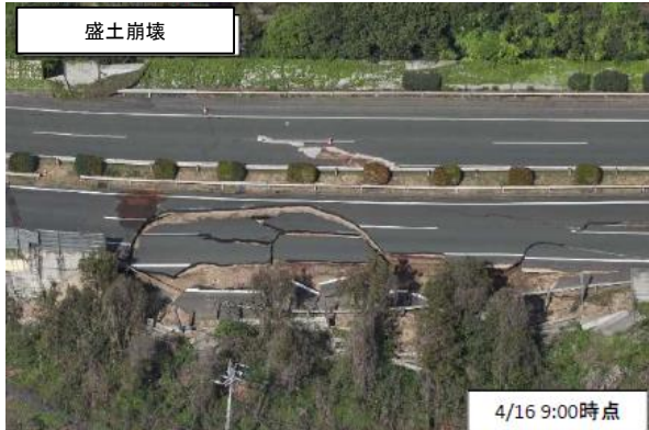
ましきまち (九州自動車道益城町) 写真-1 盛土崩壊の状況
