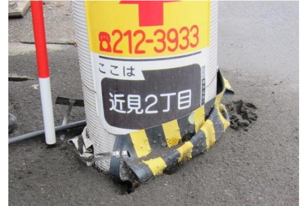
みなみくちかみ (町道 熊本市南区近見) 写真-6 電柱の沈下の状況
