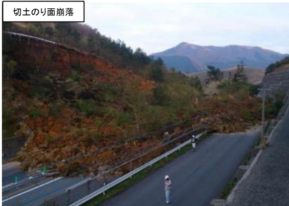
ゆふ (大分自動車道由布市) 写真-2 切土のり面崩壊状況
