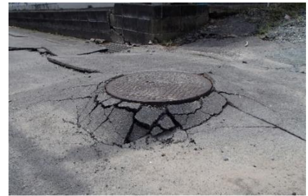
ましきまちてらさこ (国道443号益城町寺迫) 写真-5 マンホールの浮き上がり及び周辺 地盤の沈下の状況
