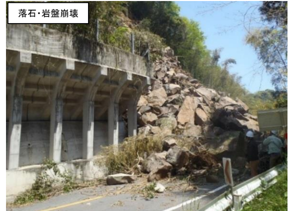
みふねまちたきお (国道445号御船町滝尾) 写真-4 岩盤崩壊の状況
