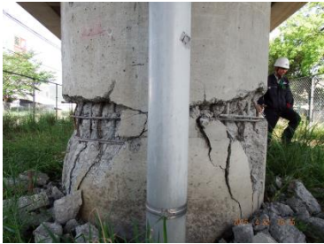
写真-1 市道中央線・中央線陸橋 における段落し部の損傷
