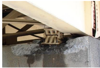
写真-2 九州自動車道・木山川橋 における支承部の損傷
