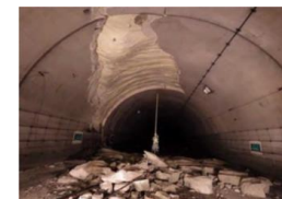
写真-1 覆工コンクリートの崩落（俵山トンネル）
