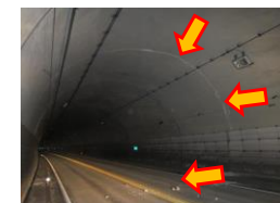
写真-2 覆工コンクリートのひび割れ（南阿蘇トンネル）
