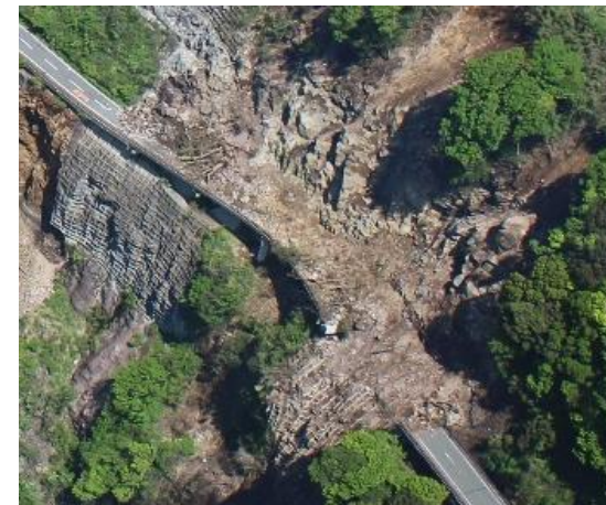
写真-9 斜面崩落による橋の流出 (戸下大橋)
