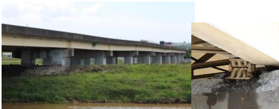
写真-2 上部、下部構造の損傷 (木山川渡河部 木山川橋 左:全体、右:支承部の損傷)
