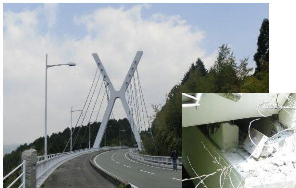
写真-6 支承部の損傷 (桑鶴大橋)
