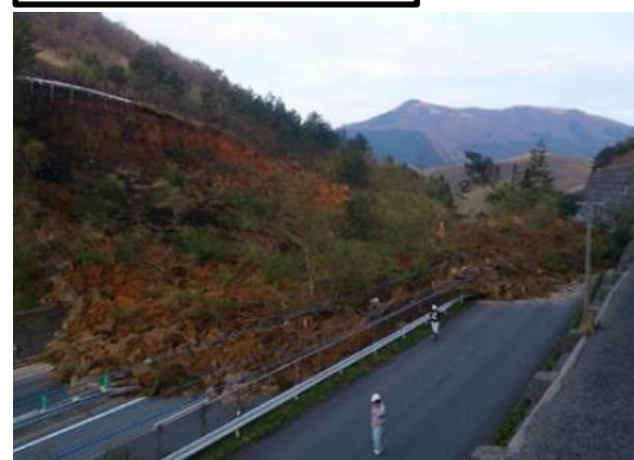
写真-4 切土のり面の崩壊 (由布岳PA付近)
