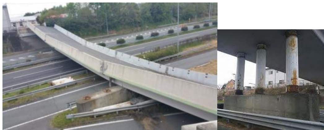
写真-3 跨道橋の落橋 (熊本県道府領第一橋 左:落橋後、右:落橋前)
