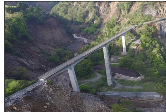
写真-8 橋台の損傷 (阿蘇長陽大橋)
