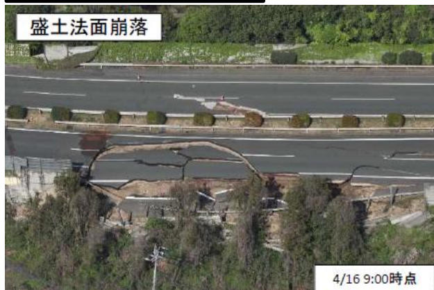
写真-1 盛土の崩壊 (益城バスストップ付近)
