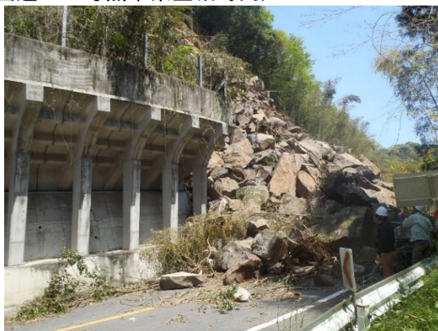
写真-11 落石・岩盤崩壊により全面的に通行止め (国道445号熊本県御船町内)
