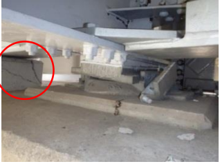
写真-6 支承の破損の状況
