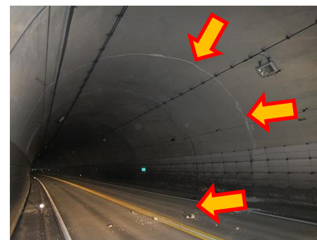
写真-4 輪切り状のひび割れとわずかなはく落の状況
