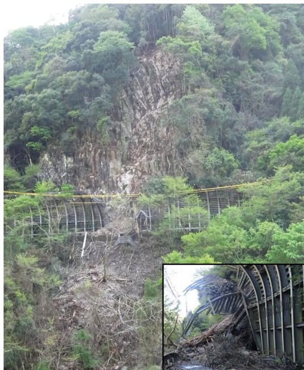
写真-1 落石防護施設では防ぐことができず、路面に岩塊が到達
