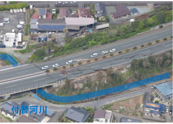
写真-2 九州自動車道の盛土崩壊全景
