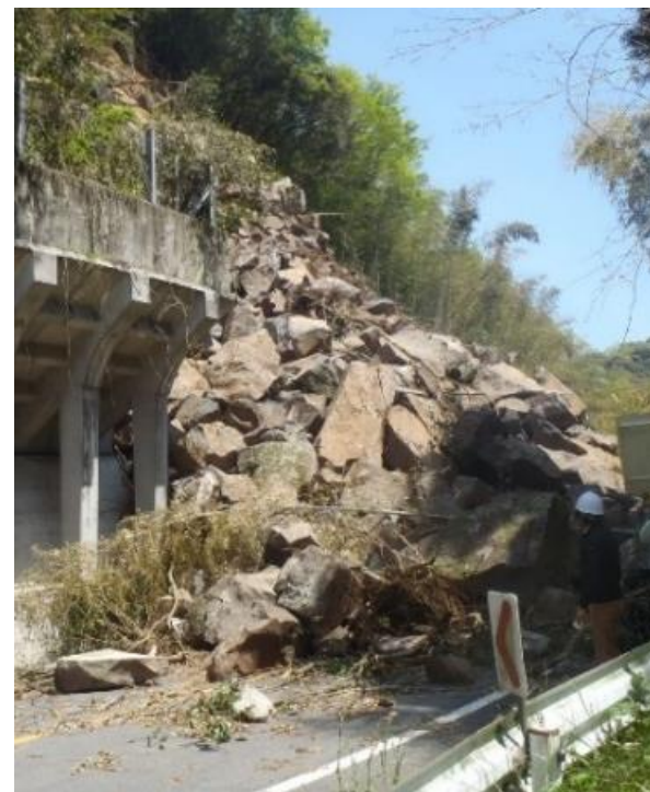
写真-3 落石防護施設の脇に崩落し、車線を完全に塞いでいる溶結凝灰岩
