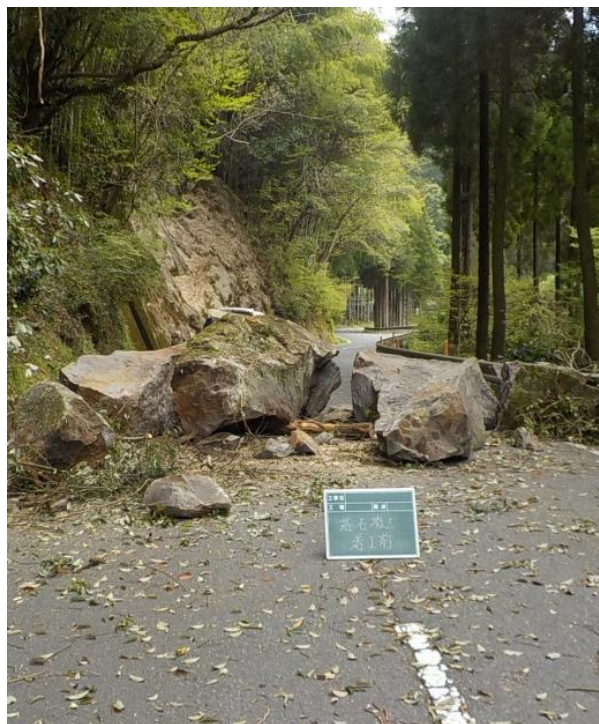
写真-2 路面に落下した落石の状況（要対策箇所）
