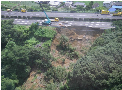
写真-1 盛土崩壊状況
