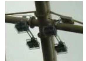
【照明施設再整備後 (LED400W+非常用発電設備)】
