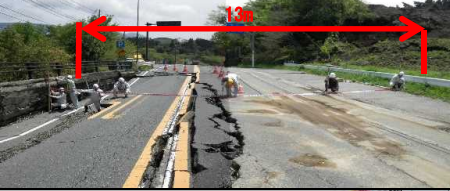
国道57号 阿蘇郡南阿蘇村 擁壁倒壊 路面陥没
