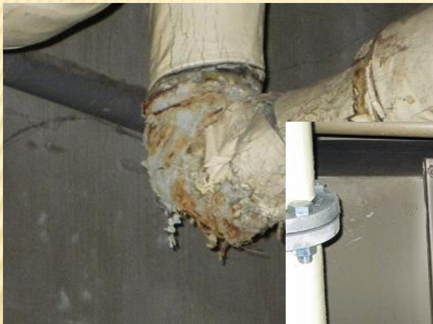
配管硅藻土保温材
