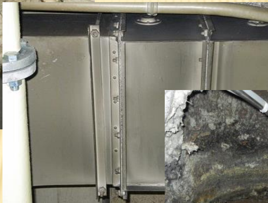
ダクト保温材(パッキン)
