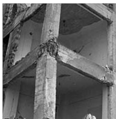
最近の接合部の地震被害
