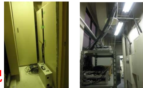
電力量 測定状況
