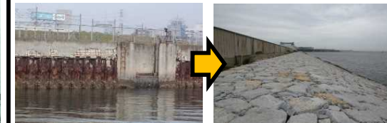
コンクリートの劣化
