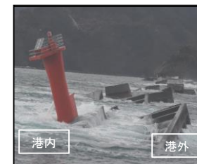
釜石港の湾口防波堤被災状況
