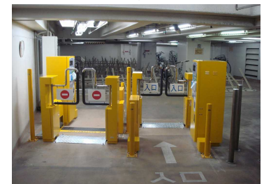
出入口ゲート
