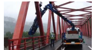
点検システムの背面
